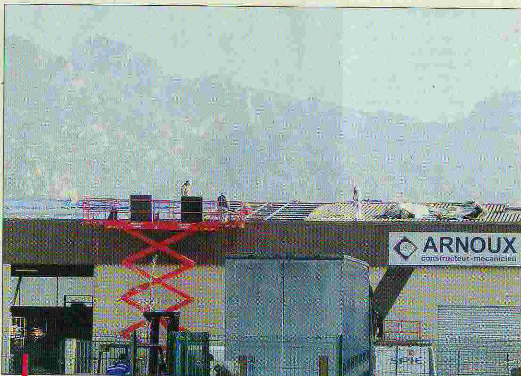
L'entreprise Arnoux installée dans la zone industrielle des Paluds est entrain d'installer des panneaux photovoltaïques sur son toit. Près de 1500m 2 de pose sont prévus. / PHOTO R.A.
